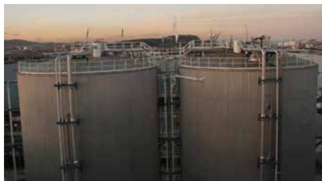
Impianto di trattamento rifiuti Ecoparc 1 a Barcellona.
